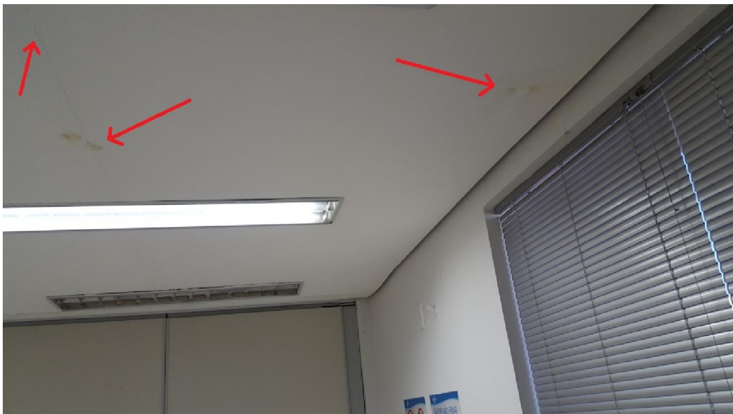
Foto 06 (Auditório) – Infiltração, e trincas no forro. Solução: Sanar a fonte de infiltração, e refazer o forro.
