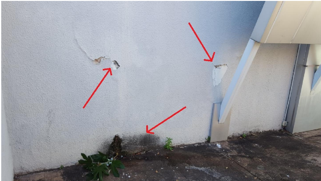
Foto 13 (Fachada Lateral) – Bolor, descascamento e formação de vesículas. Solução: Renovação da camada de reboco, e eliminação da fonte de umidade.
