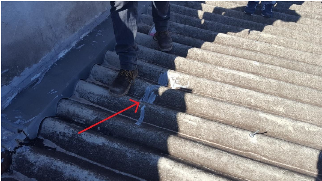
Foto 10 (Cobertura) – Telhas rachadas, e deterioradas. Solução: Troca das telhas.
