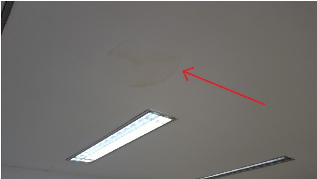
Foto 05 (Auditório) – Infiltração. Solução: Sanar a fonte de infiltração, e refazer o forro.
