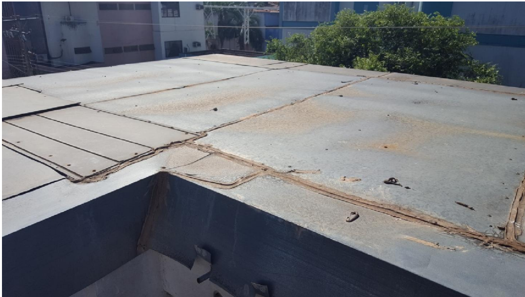
Foto 17 (ACM da Cobertura da Fachada) – Problemas na junta e deformação das placas. Solução: Troca das placas danificadas e refazer as juntas.
