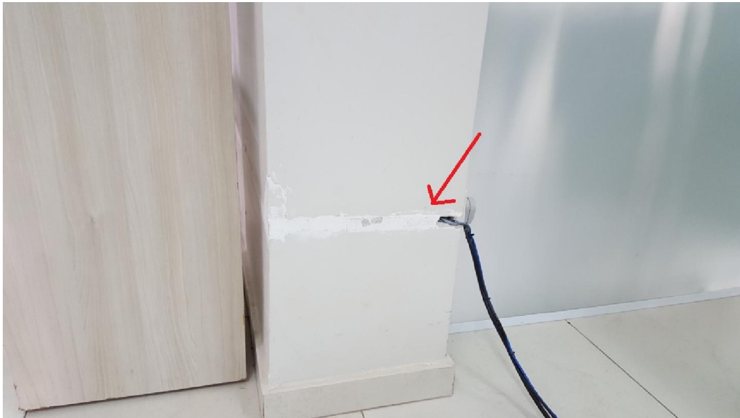
Foto 03 (Escritório) – Instalação elétrica/lógico improvisado. Solução: Refazer a instalação, e pintar.
