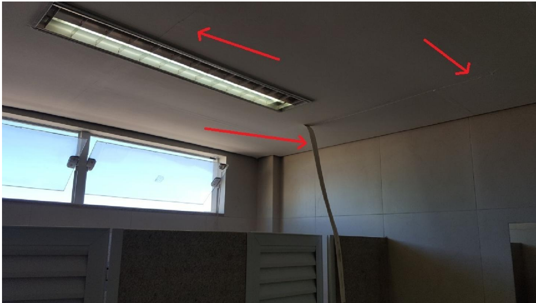
Foto 07 (Banheiro) – Descolamento das faixas de acabamento, trincas, e caimento das placas de gesso. Solução: Refazer o forro.
