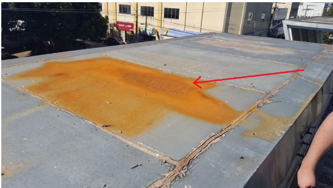
Foto 14 (ACM da Cobertura da Fachada) – Ferrugem, corrosão, infiltração. Solução: Troca das placas danificadas com tratamento adequado, e troca das juntas.
