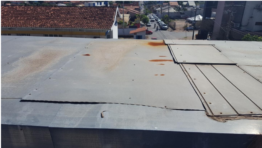
Foto 20 (ACM da Cobertura da Fachada) – Problemas na junta e deformação das placas. Solução: Troca das placas danificadas e refazer as juntas.
