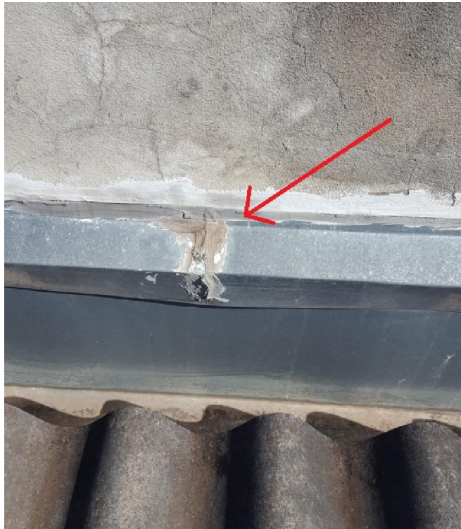
Foto 11 (Cobertura) – Rufos e calhas soltas e mal fixadas. Solução: Fixação dos rufos e calhas existentes ou a troca dos mesmos.
