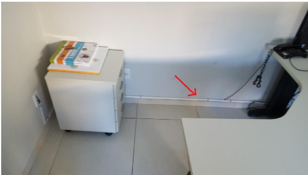
Foto 02 (Escritório) – Instalação elétrica/lógico exposto. Solução: Embutir, e pintar.
