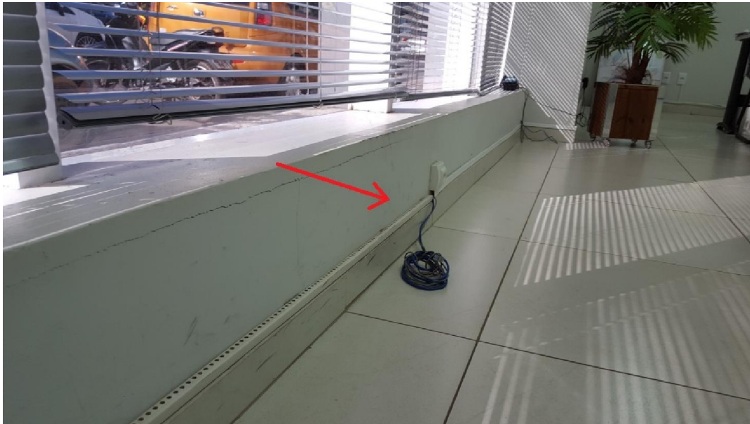
Foto 01 (Escritório) – Instalação elétrica/lógico exposto. Solução: Embutir, e pintar.
