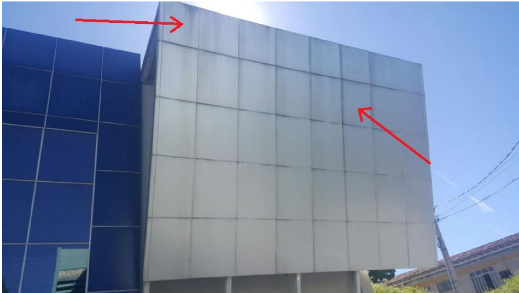
Foto 15 (ACM da Fachada) – Manchas escuras nas placas e juntas das mesmas. Solução: Uma possível limpeza pode resolver os problemas das placas, todavia as juntas devem ser trocadas.
