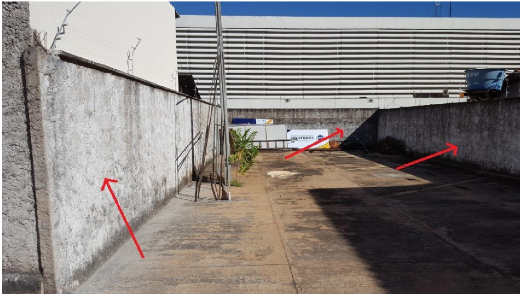
Foto 09 (Estacionamento Interno) – Bolor e manchas. Solução: Aplicação de tintas com maior resistência a intempéries.
