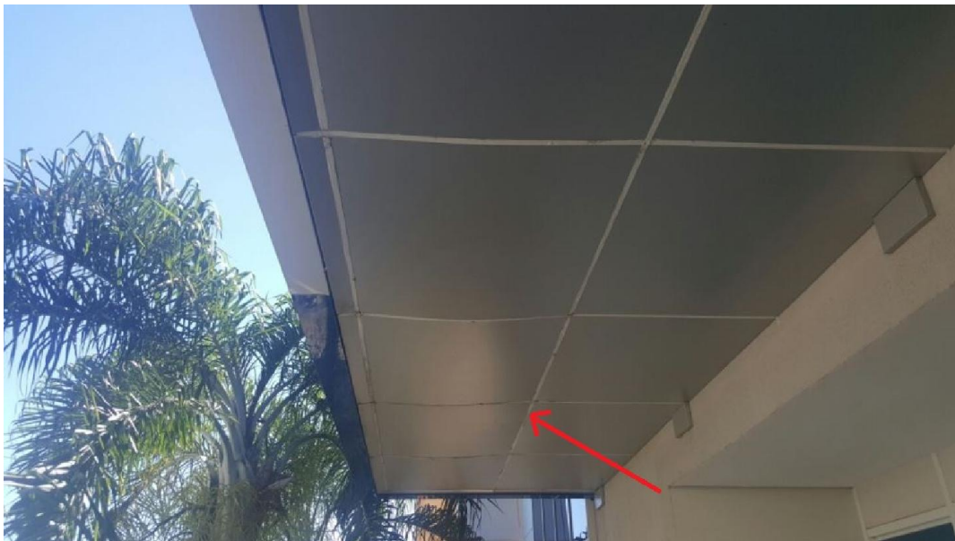
Foto 16 (ACM Inferior da Fachada) – Infiltração e deformação das placas. Solução: Troca das placas danificadas e eliminação da infiltração.
