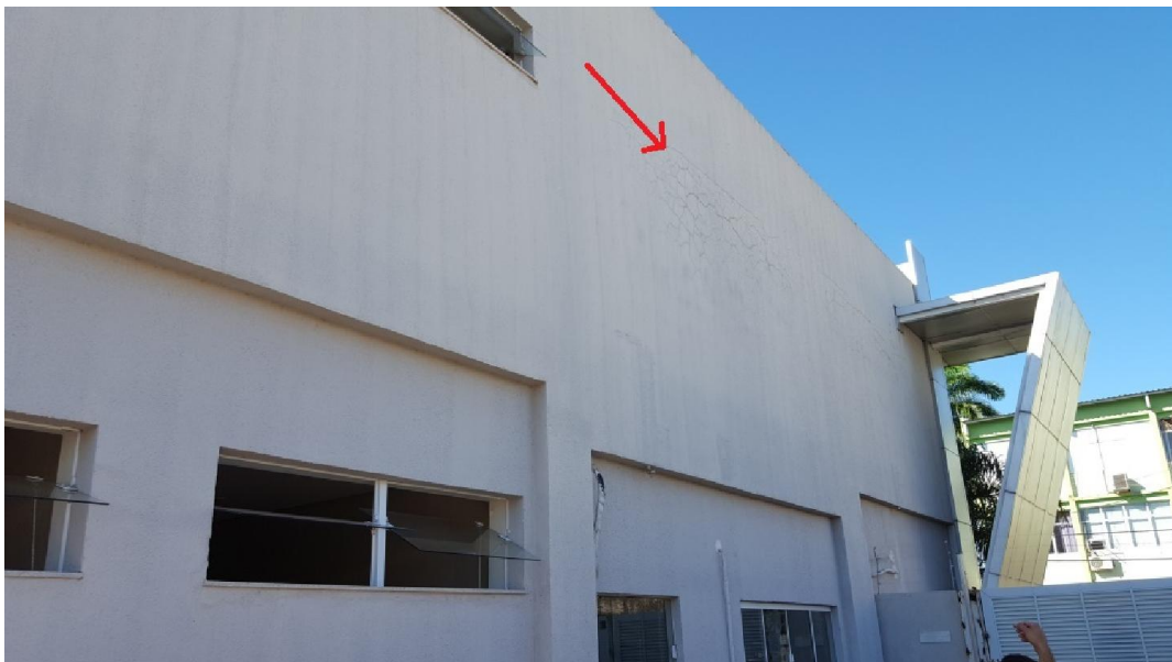
Foto 08 (Fachada) – Fissura mapeada por retração térmica. Solução: Renovação do revestimento e aplicação de tintas e selantes flexíveis.
