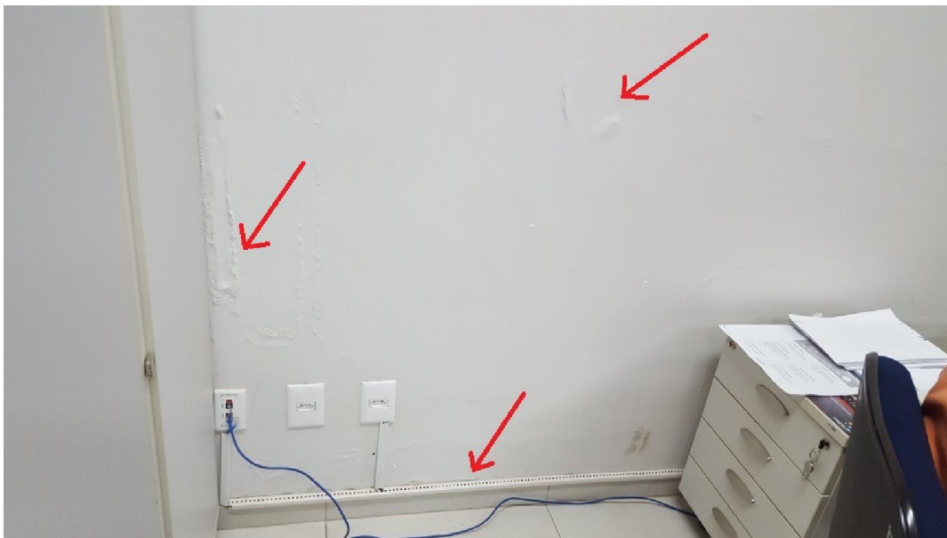
Foto 04 (Escritório) – Instalação elétrica/lógico exposto; Descascamento da parede; Infiltração. Solução: Embutir as instalações, sanar a fonte de infiltração e refazer os serviços de pintura.
